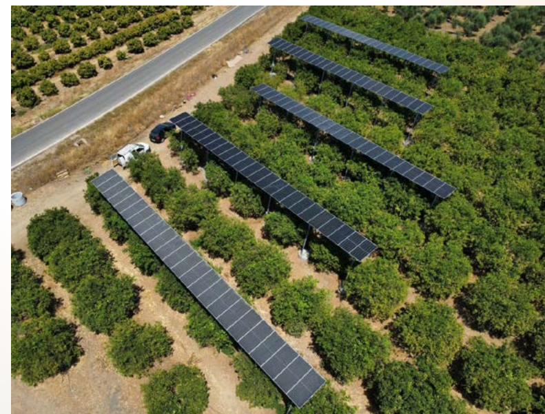
Imagen 2: Instalación Agrovoltaica del proyecto GO Agrivoltaica And (instalación en altura sobre cítricos) en Córdoba.
