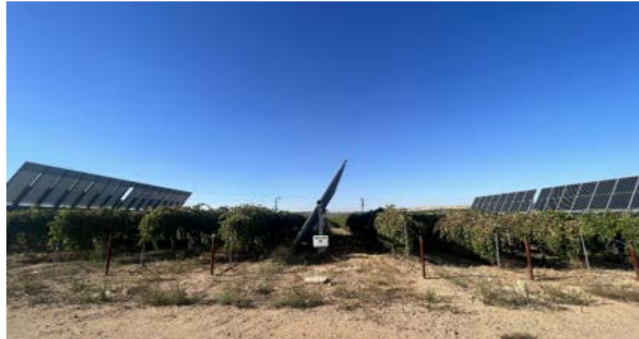
Figura 47: Instalación de Agrovoltaica en la Finca Daramezas, de Viñedos del Río Tajo
