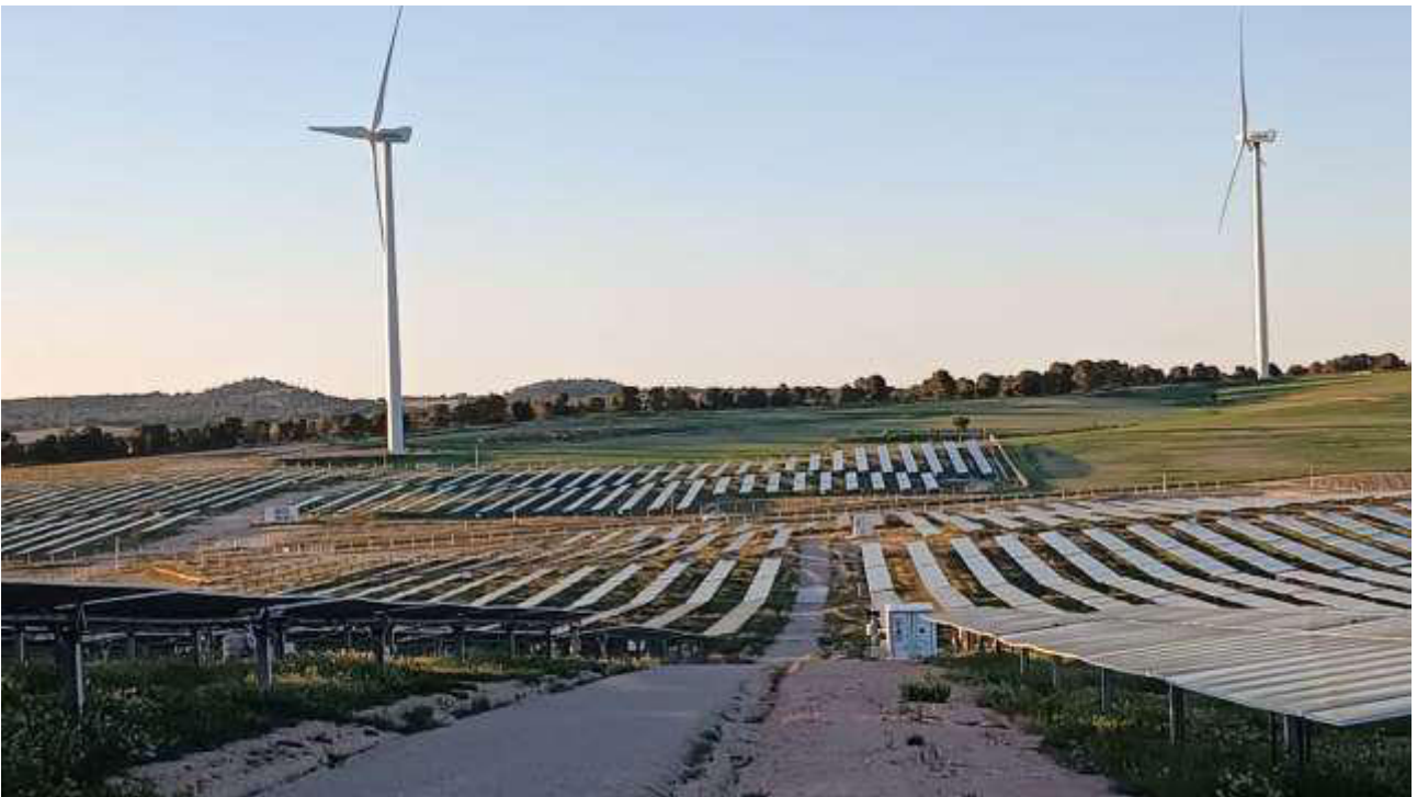
Vista general de la instalación fotovoltaica
