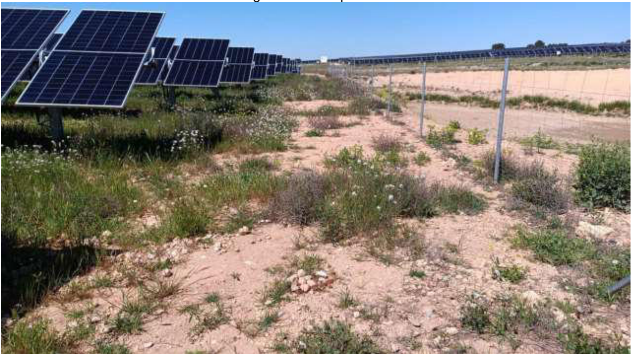
Vista del perímetro de la planta solar el día 23/04/2025
