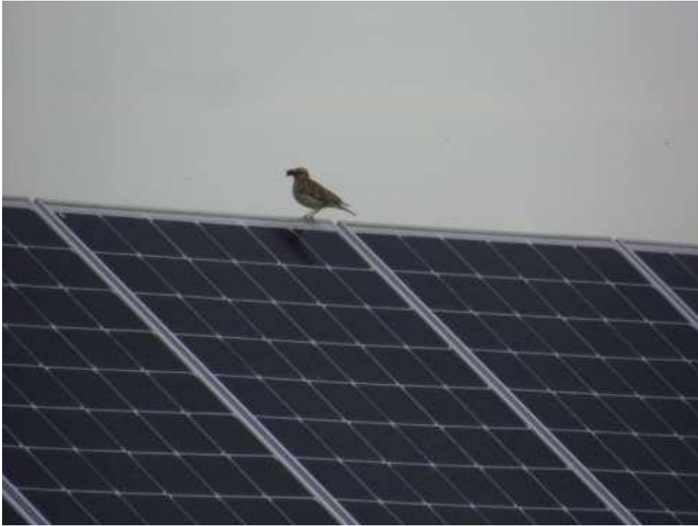
Alondra totovía ( Luullula arborea ) con ceiba posada en paneles de la planta FV en la visita del día 21/05/2025
